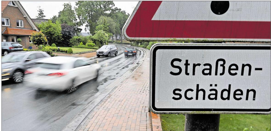
Sanierungsbedürftig: Ein Flickenteppich ist die Kreisstraße in Höltinghausen zwischen Grundschule und Volksbank.
